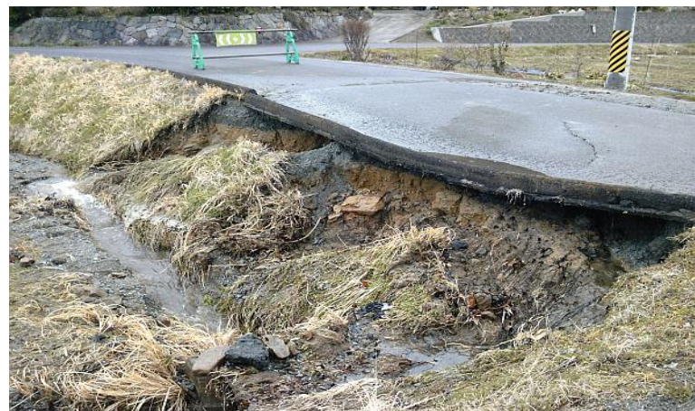
施設の老朽化や突発事故、災害による施設の損傷
