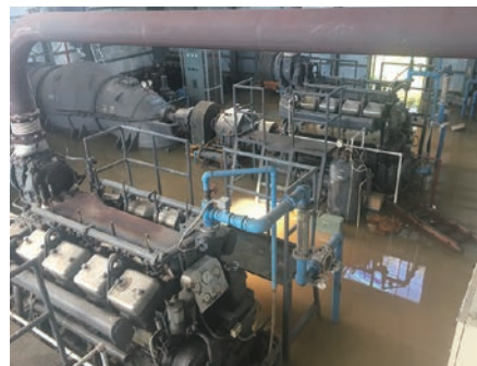
江尻第3排水機場 水没
