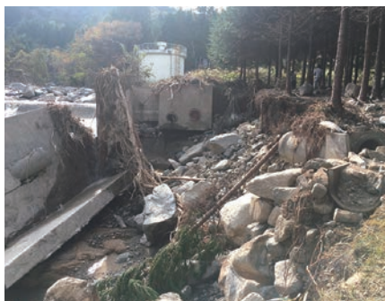
丸森町大内 土合堰崩壊
