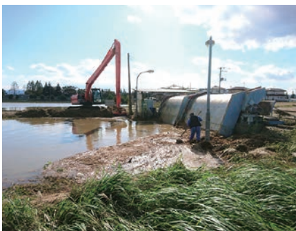
大堀除塵機 稲わら除去
