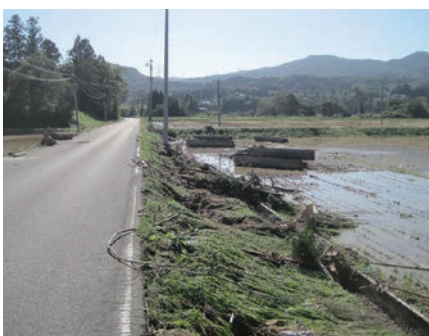
用水路の破損
