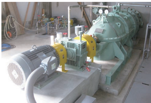
坪石揚水機場 事業費：100,000,000円 1号主ポンプ設備整備、補機類更新 (負担割合：50%、県25%、市15%、改良区10%)
