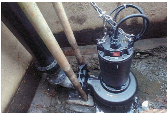
荒神揚水機場 事業費：9,900,000円 1号主ポンプ設備整備、補機類更新 (負担割合：国30%、県30%、改良区40%)
