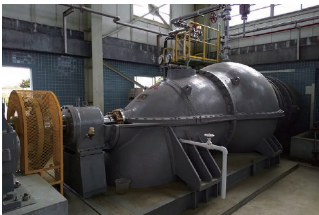
中谷地排水機場 事業費：56,400,000円 1号、3号主ポンプ設備整備、補機類更新 (負担割合：50%、県25%、市15%、改良区10%)
